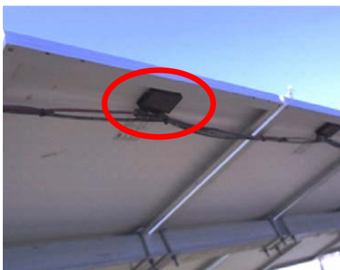
Caja de conexiones y diodos de protección
