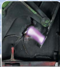
Arco fijo de conmutación como consecuencia de la activación del dispositivo de desconexión
