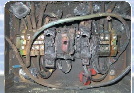
Dstrucción del dispositivo de protección, debido a la aplicación de soluciones de alterna en instalaciones de continua
